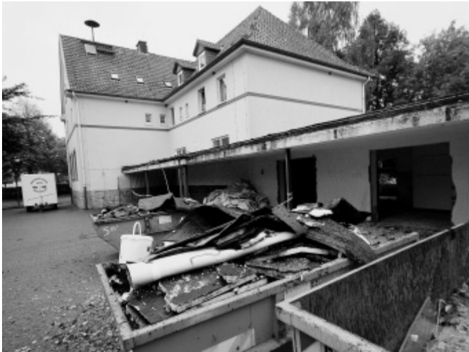
Die Container sind voll: Der Flachbau hinter dem Altbau ist bereits entkernt.
