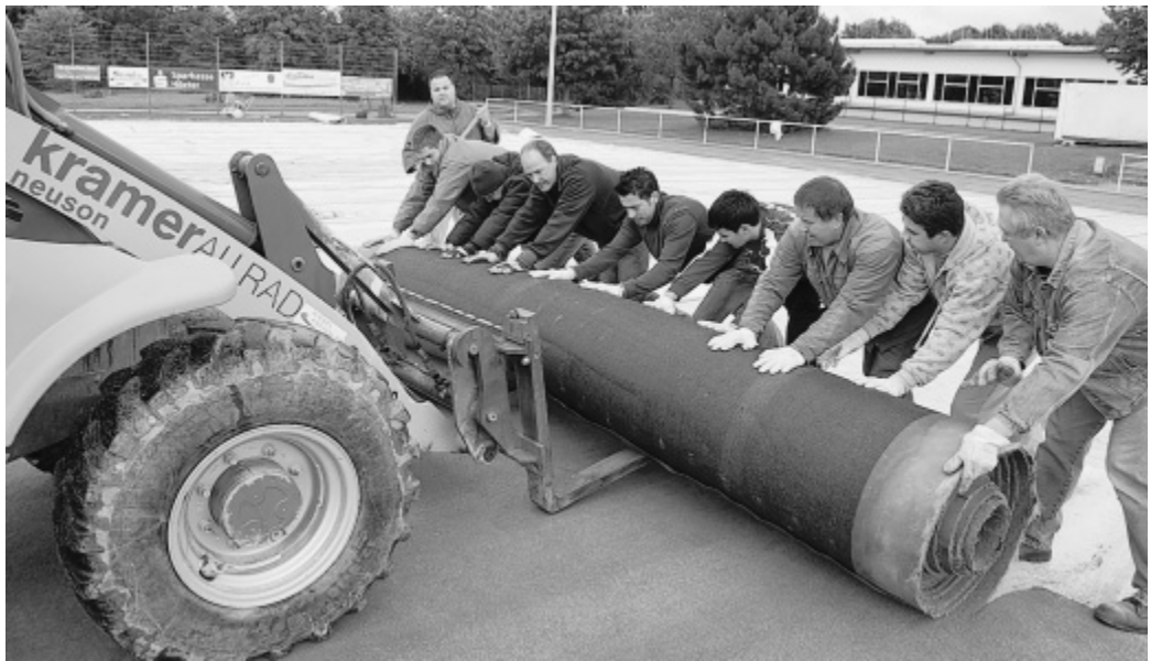
Mit vereinten Kräften: Zusammen schafften es die neun Männer, unter denen auch Friedhelm Borgmeier, Leiter des Bau- und Planungsausschusses der Stadt Steinheim, war (4. v. l.), die schwere alte Kunstrasenbahn auf die Staplergabel des Baggers zu rollen.
