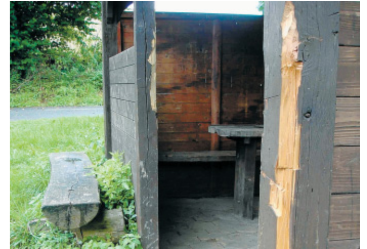
Zerstörungswut: Mit einem Beil oder einer Axt wurden die Holzbalken der Hütte am Struckstein stark beschädigt.
